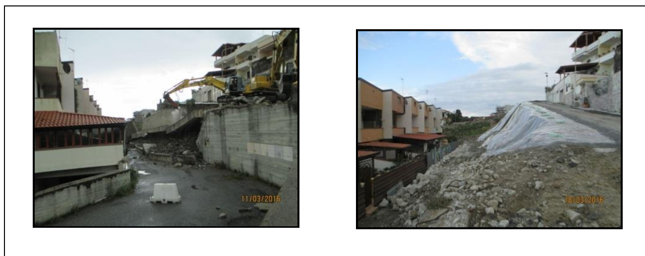
Figura 2 - Foto del sito negli istanti immediatamente successivi al crollo.
