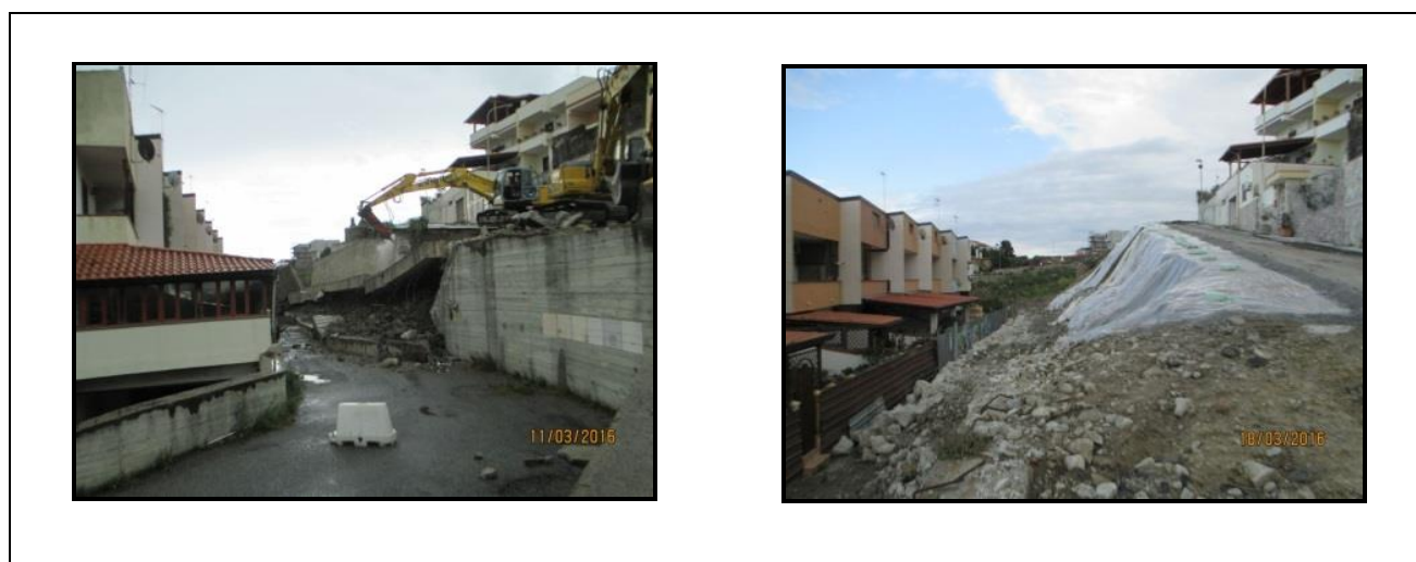
Figura 8 - Foto del sito negli istanti immediatamente successivi al crollo.
