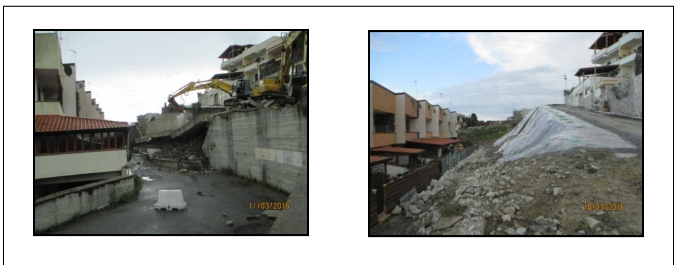
Figura 6 - Foto del sito negli istanti immediatamente successivi al crollo.
