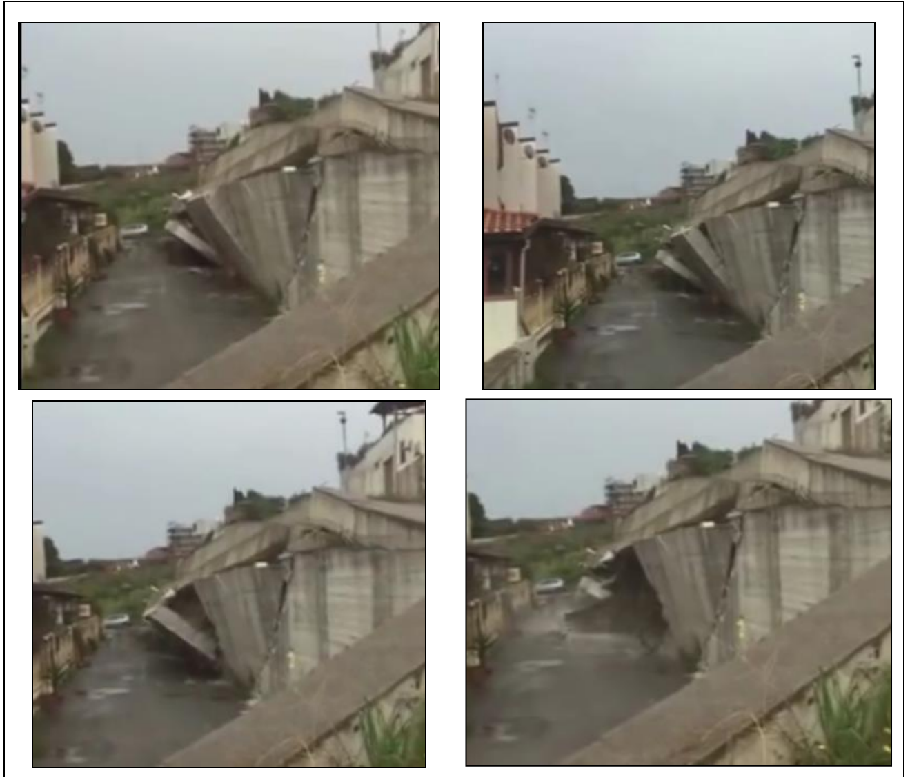
Figura 5 – Fasi del crollo (estratti da video girato dall'ufficio tecnico comunale).
